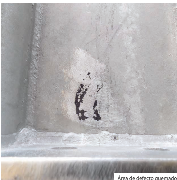
Área de defecto quemado
